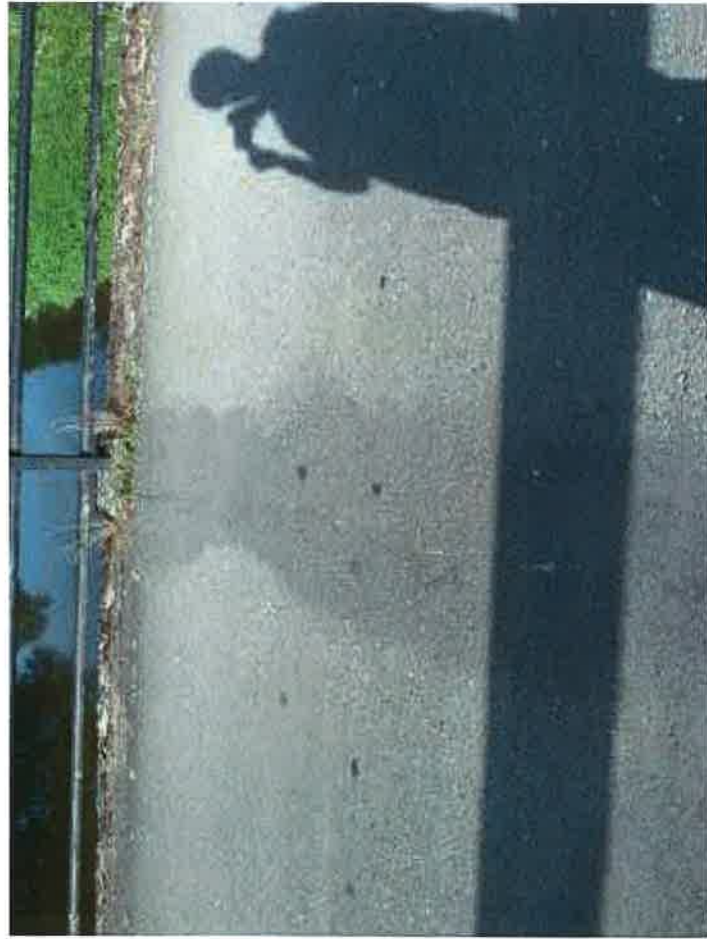
13 trhina nad pilifem.JPG
